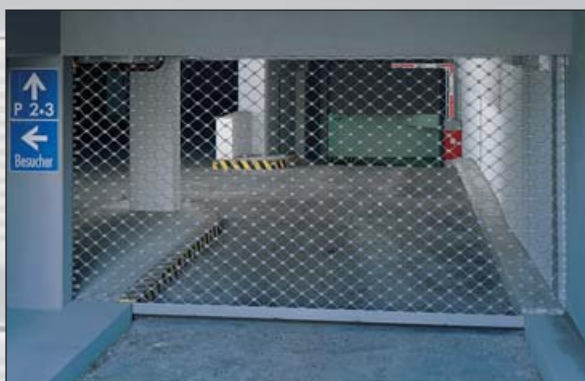
Ochrana a větrání podzemních garáží.
