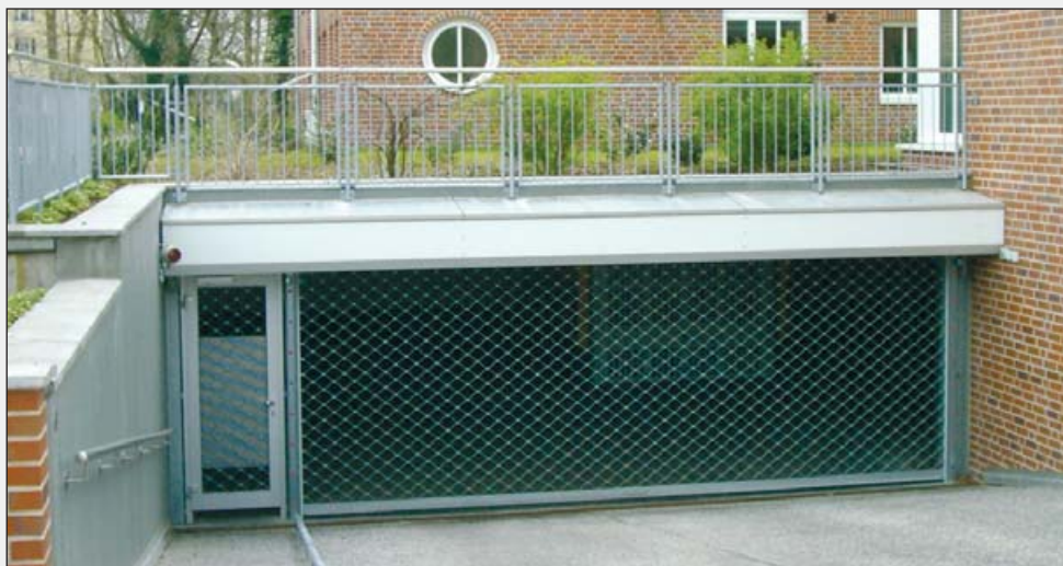
Rolovací mříž s vedlejšími dveřmi v podzemní garáži.
